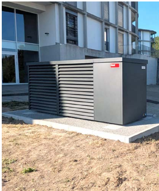
Die Ausseneinheit der neuen Luft-Wasser-Wärmepumpe in der Liegenschaft Hasenbühlstrasse 4 in Heiden. Sie ersetzt 2026 die bisherige fossile Heizung.
